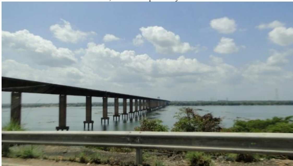
Figura 05 - Ponte Rodoferroviária sobre o Rio Tocantins, 2.310 metros, por onde também passa o trem de minérios, vindo e indo para Carajás-São Luís.
